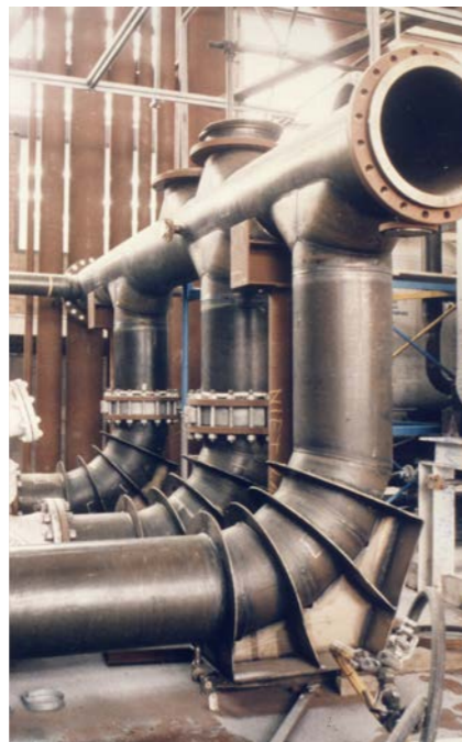
Abbildung 34: (DKI A 4971) Seewasser-Rohrleitungssysteme aus CuNi10Fe1Mn auf der Plattform Tartan A
