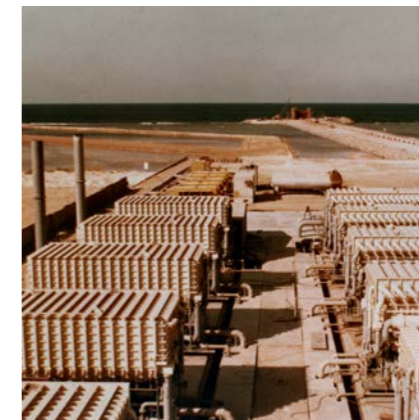
Abbildung 38: (DKI A 1226) Meerwasserentsalzungsanlage in Jeddah (Saudi Arabien) mit einer Leistung von 10 X 500 m 3 = 5000 m 3 /Tag. Alle Seewasser führenden Rohrleitungen, Kondensatoren, Trennwände, Rohre des Enderhitzers, Gehäuse, Destillatwannen und andere wichtige Teile des Verdampfers bestehen aus CuNi10Fe1Mn
